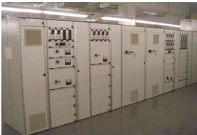
Figura 2.6.8.a) Centro control de Motores
