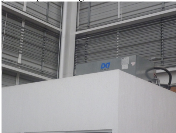
Foto 1.- Equipo CRAC, no cumple con ASHRAE
