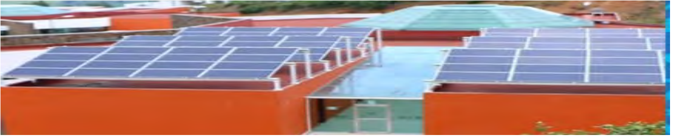
Figura 39: Paneles solares en las aulas Fuente: Obtenida de la página de la UICEH 68
