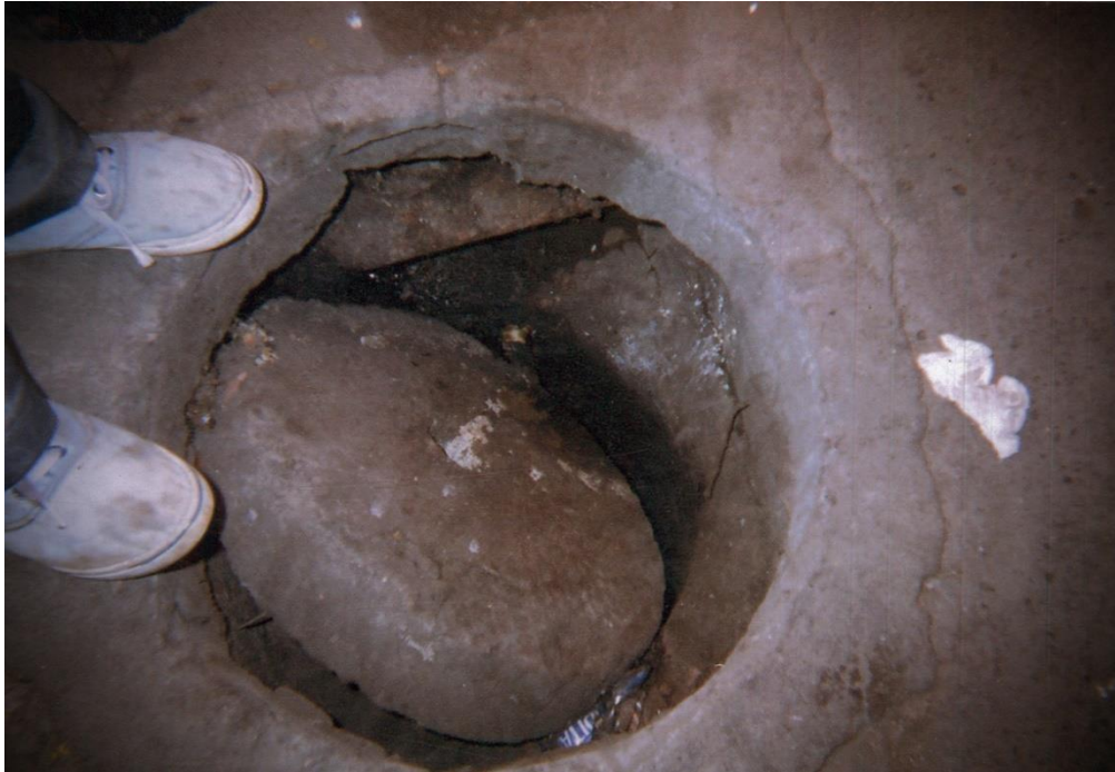
Fotografía 1. «Mi hermano se cayó en esta coladera. Aquí salen sus pies; se fue por la coladera. La coladera estaba sumida, y a mi hermano se le ocurre pasar por arriba y se metió. Está peligroso, ahorita mi hermano la libró, pero habrá gente que no». «Alcantarilla abierta», Fernanda, estudiante universitaria, 18 años.
