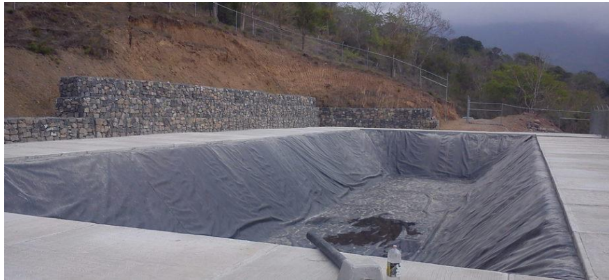
Figura 8.2: Geomembrana plástica empleada para impermeabilizar un estanque de almacenamiento de agua.
